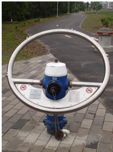
Figure 2. Borne fontaine avec point d'eau potable
